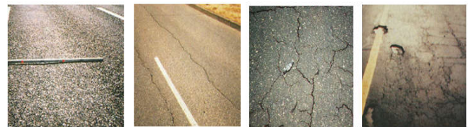
(a) Deformation (b) Fatigue cracks (c) Faïençage (d) Potholes
